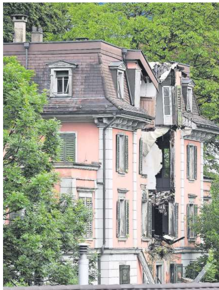
Die Villa Landenberg ist am Zerfallen und einsturzgefährdet.
